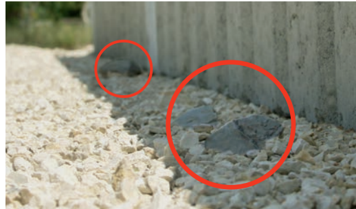
Abb. 79: Kornanteile aus der Tragschicht in der Bettung können zu Schäden führen
